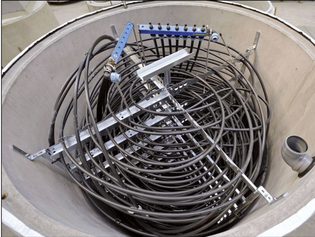
Figuur 6 Ijsbuffervat in niet-gevulde staat (Bron: www.viessmann.com )
