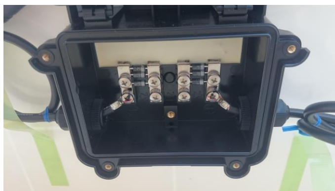
Figuur 4.21: bypassdiodes op testmodule
