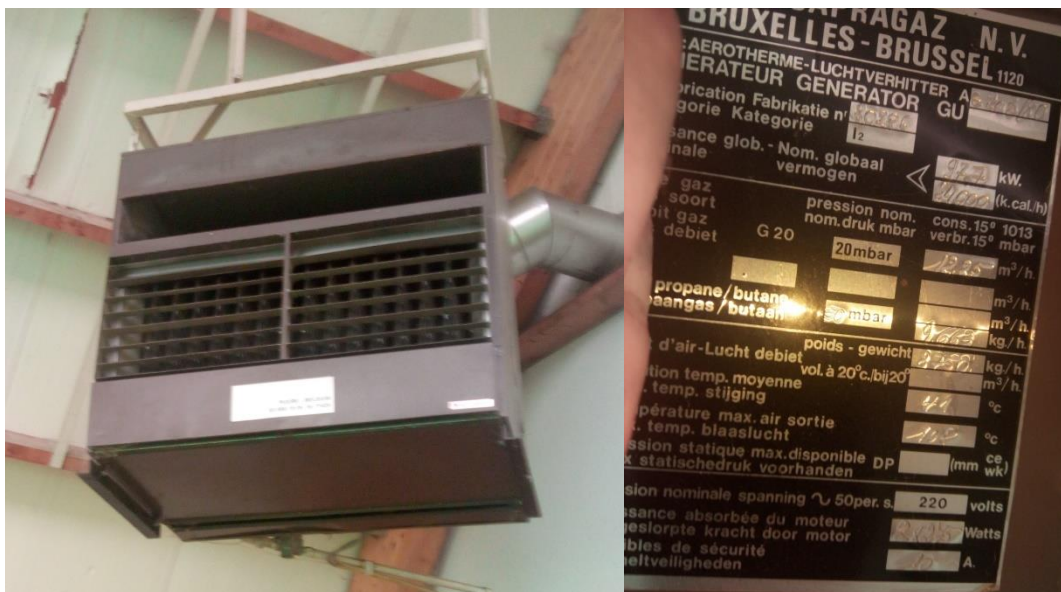
Figuur 4-3 Oude gasgestookte luchtverwarming met kenplaat
