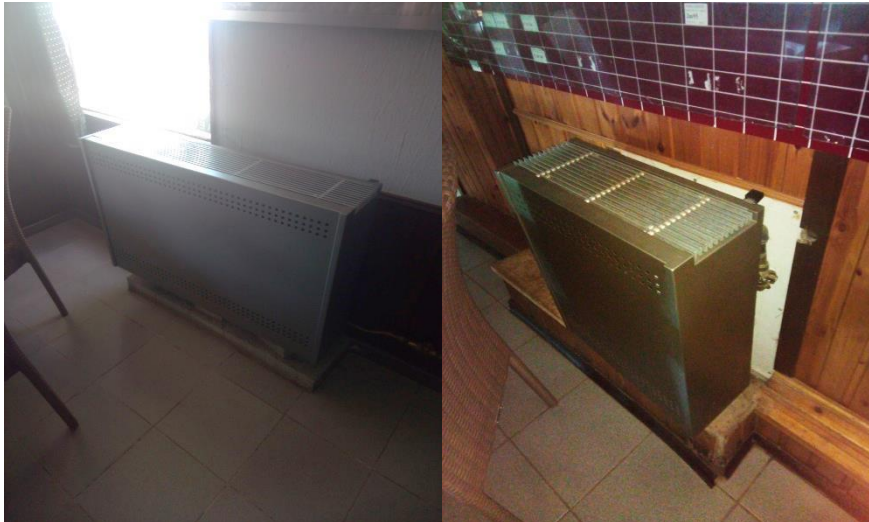
Figuur 4-9 Gas convectoren kantine chalet
