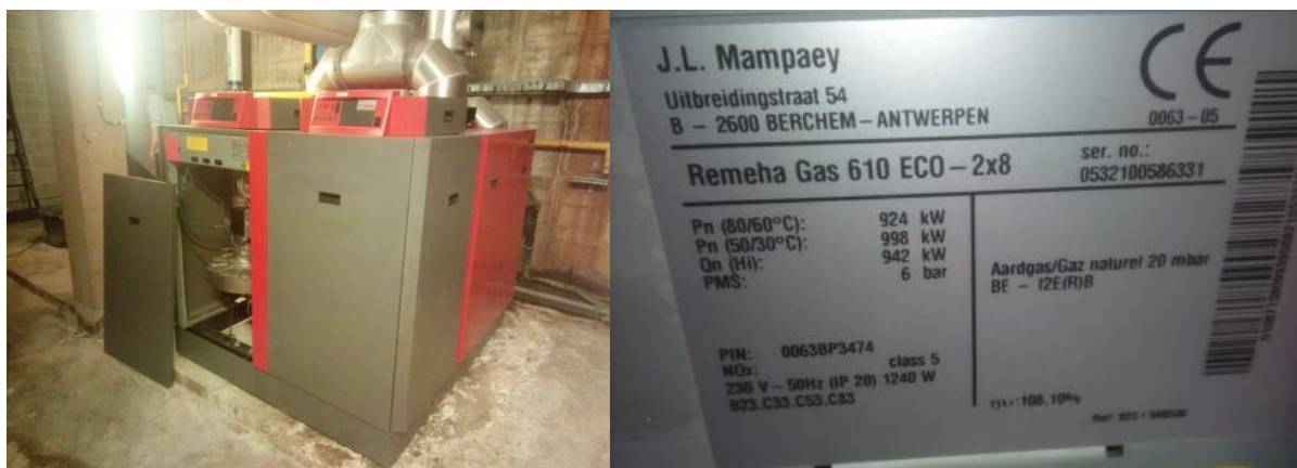
Figuur 4-1 Remeha gas 610 eco - 2x8 met kenplaat
