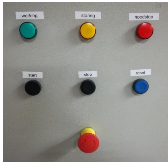
Figuur 71: foto van de deur van de PLC kast
