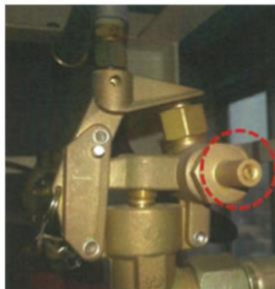
Figuur B16 Sluitschroef op de laatste CO 2 -cilinder Bron: Tyco Seaplus (2014)
