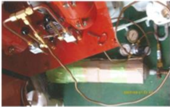
Figuur B19 Koperen pijpleidingen in en vanuit het CO 2 -bedieningspaneel Bron: Tyco Seaplus (2014)
