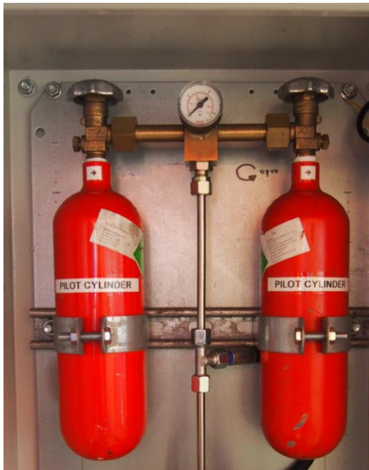
Figuur B11 Twee startcilinders met draiventiel geplaatst in het CO 2 -bedieningspaneel Bron: eigen werk
