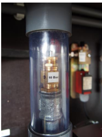
Figuur 30 Overdrukventiel met leiding naar buiten Bron: eigen werk
