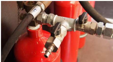
Figuur 24 Vulkraan op CO2 cilinders Bron: eigen werk
