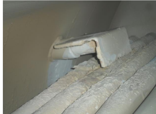
Figuur 26: Kalkafzetting bij voedingswateringang
