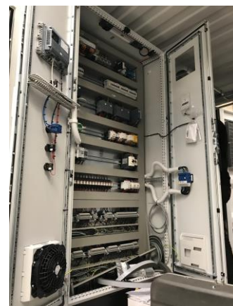
Figuur 48: Elektrische schakelkast
