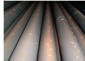
Figuur 21: Putcorrosie t.g.v. zuurstof in het ketelwater
