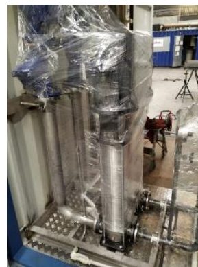
Figuur 42: Pompgroep beschermd tegen las
