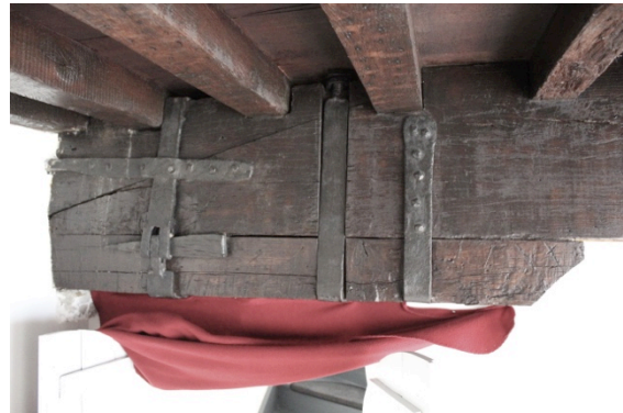
Afb. 86: Oudere versteviging aan moerbalkkop, smeedijzeren beugels, op spanning gebracht met spie, eigen erfgoedwaarde; te behouden. Voormalige Berg van Barmhartigheid, Antwerpen (auteur in kader van beheersplan door Maat_werk architecten, 2017).
