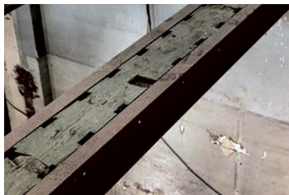
Afb. 49: Verstevigde en verlengde moerbalk met U-profielen aan weerszijden. De kinderbalken waren reeds recent vernieuwd en hadden geen erfgoedwaarde. Hôtel du Bois, Antwerpen (Denys, 2017).
