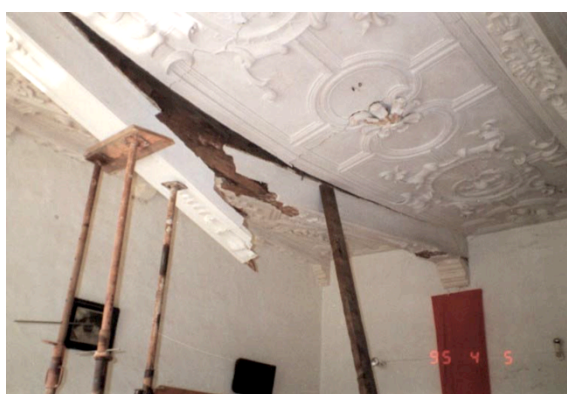
Afb. 57: Gebroken moerbalk boven waardevol stucwerk in kasteel van Horst (Laboratorium Reyntjens, 1995).
