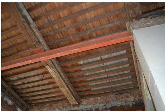
Afb. 83: Tegenvoorbeeld: moerbalken ondersteund door stalen balk in andere richting. Hôtel du Bois, Antwerpen, oudere versteviging (Origin, 2016).
