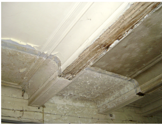
Bijlage afb. 67: Kapittelzaal niv. 0, verwijderde bepleistering van moerbalken (A. Vermijlen, 2005).
