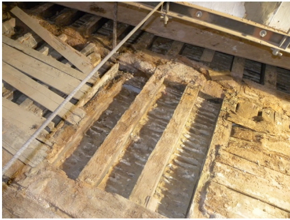
Bijlage afb. 60: Erbarmelijke staat van de kinderbalken boven het Hansche stucplafond na vrijlegging, t.g.v. vochtinfiltratie en biologische aantasting (Triconsult, 2014).
