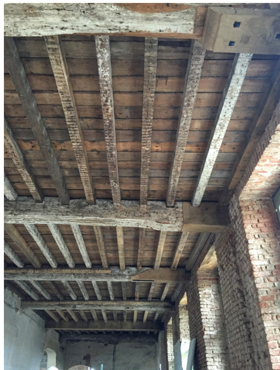
Afb. 22: Ensemble van verschillende soorten oudere balkkopherstellingen: toegevoegde houten sleutelplank (dichtstbij); epoxymortel met verloren bekisting balkkopprothese met rechte liplas; houten balkkopprothese met schuine liplas. Predikherenklooster Mechelen (auteur, 2017).
