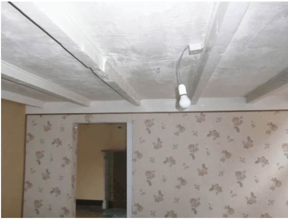
Bijlage afb. 24: Woning 2, niv. 2, bestaande toestand, vals vlak bepleisterd plafond (Triconsult, 2010).
