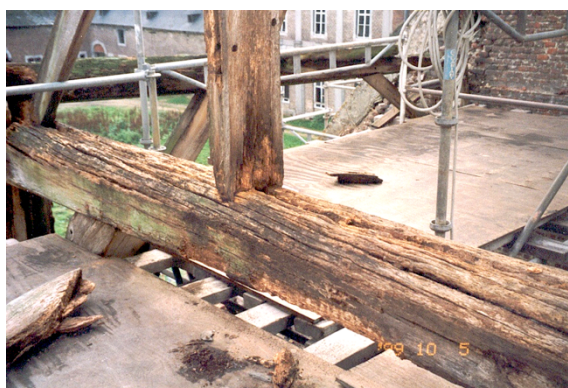
Afb. 23: Sterk aangetaste moerbalk, Tiendenschuur Herkenrode, 1999. (Heirman, G., p.299)
