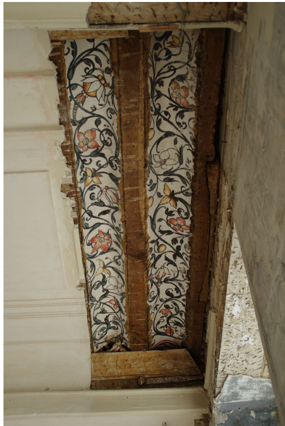
Bijlage afb. 46: 15de-eeuwse gepolychromeerde troggewelven aangetroffen onder het 18de-eeuwse stucplafond van vloer niv. 1. Dit fragment is later gerestaureerd zichtbaar gelaten voor de museumbezoeker (Triconsult, 2013).
