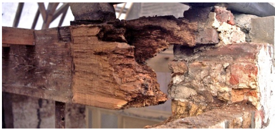
Afb. 19: Voor interventie: weggerotte balkkop en aangetaste overgangszone naar gezond hout. (Domus tech (2017))
