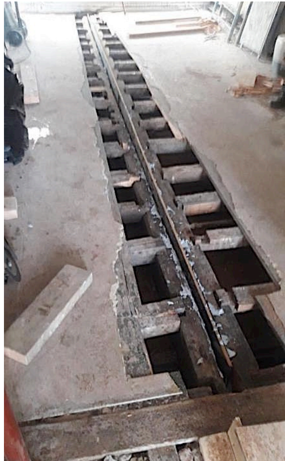
Bijlage afb. 36: Stap 2: Verlijmde staalplaat in moerbalk met Sika dur 30. Epoxyopvulling vermoedelijk meer compatibel (MRT, 2019).
