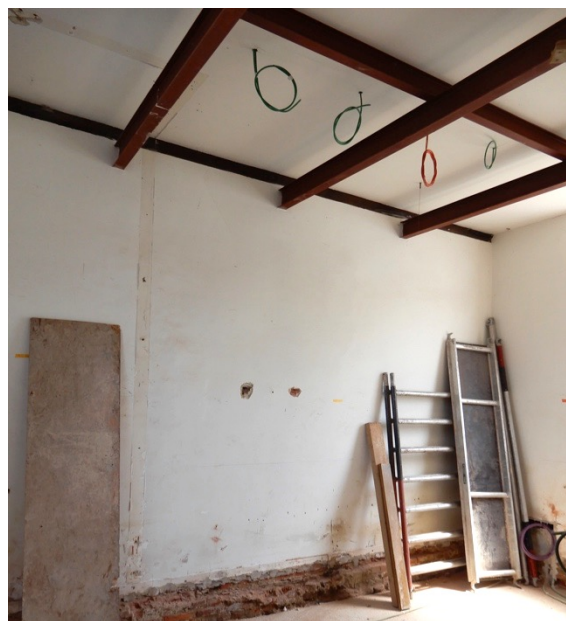
Afb. 84: Bovenste profiel (IPE 120, loodrecht op kinderbalken) wordt afgedragen op 3 onderste profielen (3x IPE 160, opnieuw evenwijdig met kinderbalken): de oorspronkelijke draagrichting is finaal behouden. Provisorenhuis, Abdij van Pak, Heverlee (Triconsult, 2019)
