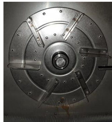
Figuur 30: De ventilator verantwoordelijk voor de luchtstroom in de klimaatkast
