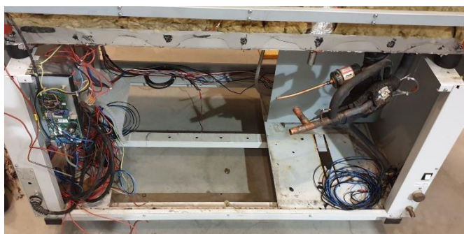
Figuur 123: De klimaatkast na demontage van de koelgroep
