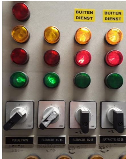
Figuur 4-20 Schakelbord verdieping 4 luchtgroepen
