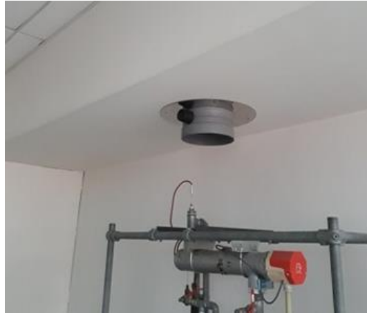
Figuur 5-2 Luchtklep zuurkastenkanaal lokaal 02.9.01.1
