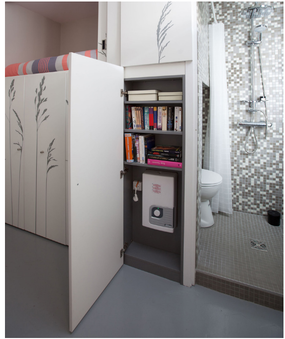
Fig. 50: Boiler, boekenplank en badkamer
