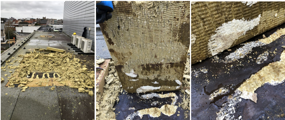
Afb. 30 (links): Stukken isolatie na ontmantelen onderlaag Afb. 31 (midden): Rotswolplaat uit onderlaag met zichtbare PUR-schuim bevestiging Afb. 32 (rechts): Aangetroffen water door inwendige condensatie of lekkage
