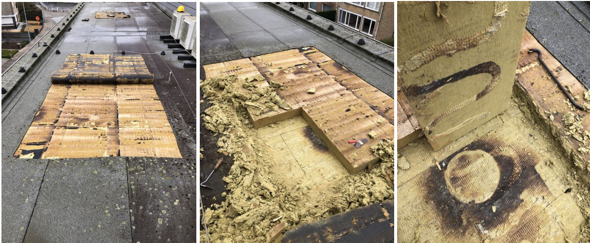
Afb. 27 (links): Dakbedekking doorgesneden met slijpschijf en verwijderd van de isolatie Afb. 28 (midden): Na ontmanteling van 1 plaat uit de bovenlaag met truweel en koevoet Afb. 29 (rechts): PUR-schuim bevestiging en afdruk van brander zichtbaar tussen boven- en onderlaag
