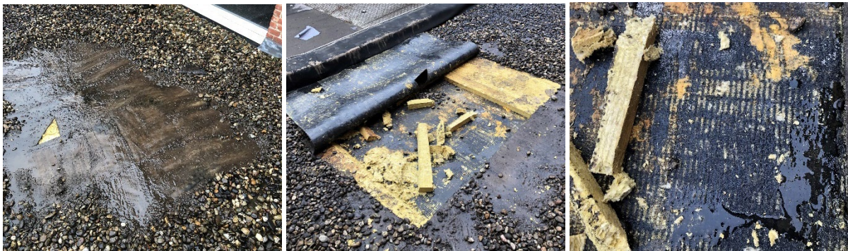
Afb. 39 (links): Insnijding in dak 3 voor check op rotswol en grindlaag verwijderd voor ontmanteling Afb. 40 (midden): Dakbedekking verwijderd en twee platen rotswol losgemaakt van het dampscherm Afb. 41 (rechts): Aanwezigheid van vocht in de dakopbouw van dak 3
