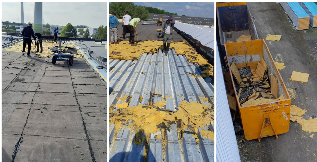
Afb. 13 (links): Dakbedekking die in stukken werd doorgesneden
