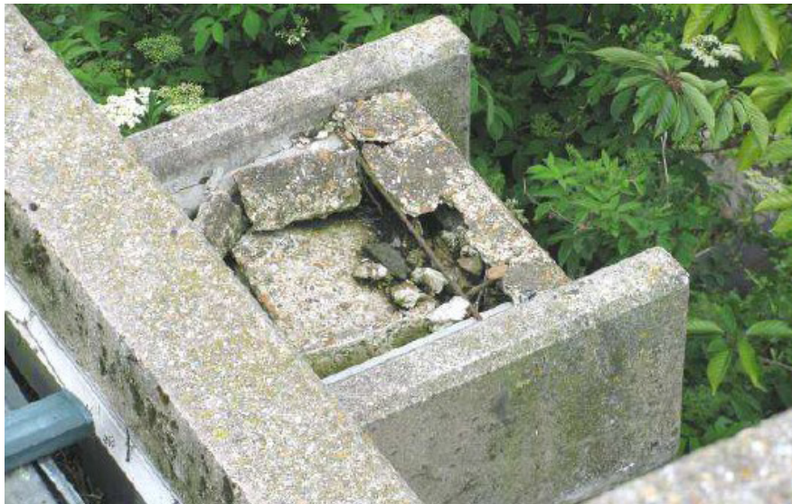
70 Schade waterafvoer zwembad
