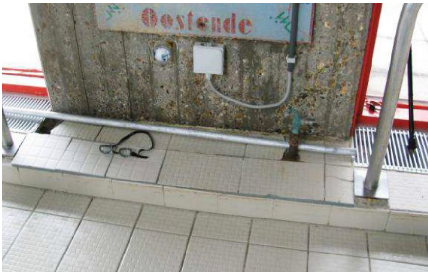
64 Schade betonmuren in de zwembadhal
