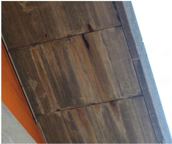
68 Schade aan het dak van de zwembadhal
