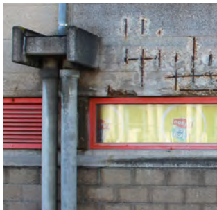
60 Zichtbare wapening aan de westgevel
