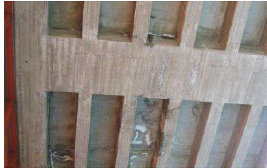
71 Schade aan het dak van de zwembadhal
