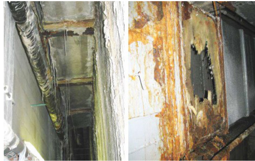
65 Betonrot in de kelder, aan de grote zwembadkuip
