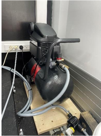
Figuur 123: Compressor rechte achter in de trailer
