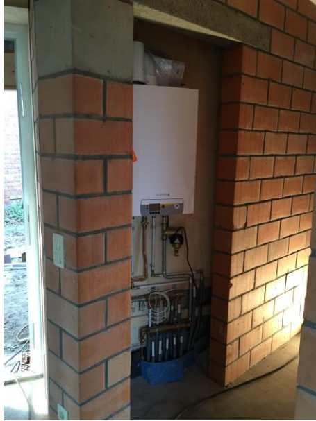
Afbeelding 61: CV-ketel IbsN woning (BLAF Architecten, 2015)
