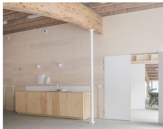
Figuur 59: Stalen kolom (Bollaert, 2024)
