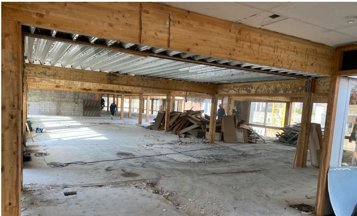
Figuur 34: De bovenverdieping van het kantoorgebouw met zichtbare opbouw van de glulamstructuur (N. Meersschant, 2022)
