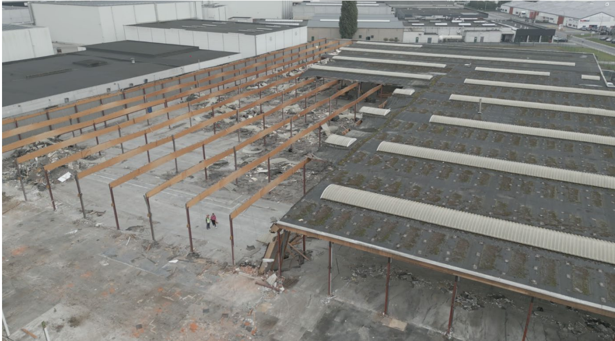
Figuur 44: De opbouw van de deels blootgelegde spanten in de loods (Provincie Oost-Vlaanderen, 2024)
