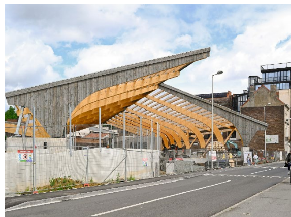
Figuur 30: Het Recypark tijdens de afwerkingsfase (alleen nieuwe spanten zichtbaar) (51N4E, z.d.)
