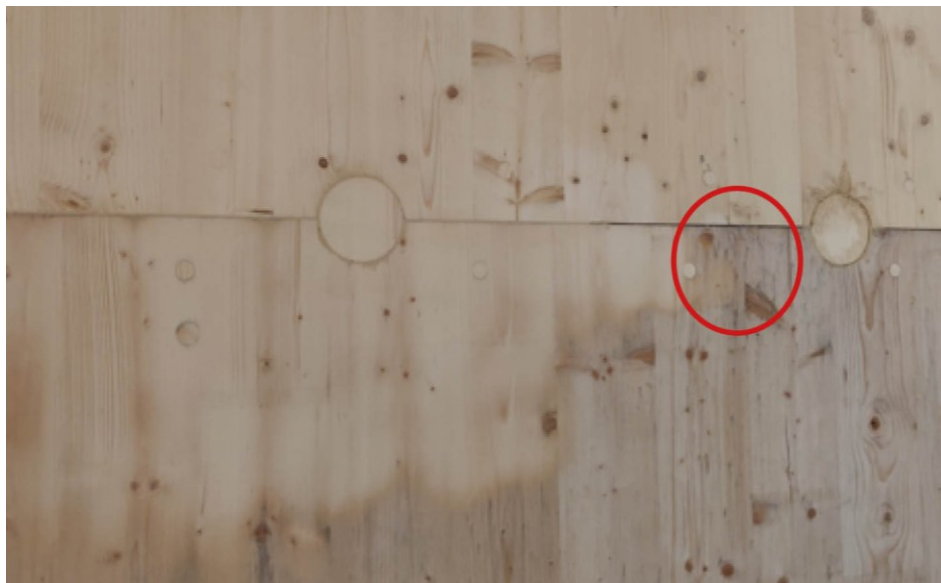
Figuur 132 - Zichtkwaliteit CLT-wand aan het trappenhuis. Hierbij is de afdakap van de Idefix-verbinding sterk zichtbaar, die overigens veel groter uitgefreesd is dan nodig. Men ziet ook het kleurverschil tussen de twee panelen, waarbij het onderste paneel ook wat blauwschimmel vertoont. Dit kan eenvoudig afgeschuurd worden, om geen egaal afgewerkte wand te bereiken. Dit laatste kost heeft echter grote tijds- en financiële gevolgen.
