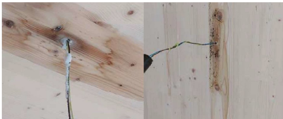
Figuur 136- Vergevevorderde schimmelaantasting na enkele maanden door het gebrek aan beschermingsmaatregelen bij een project in Sint-Jans-Molenbeek. Men merkt aan een dakdoorvoer een meer bruinachtige verkleuring, wat het begin is van een aanval van lignivore schimmels die de houtstructuur veranderen.
