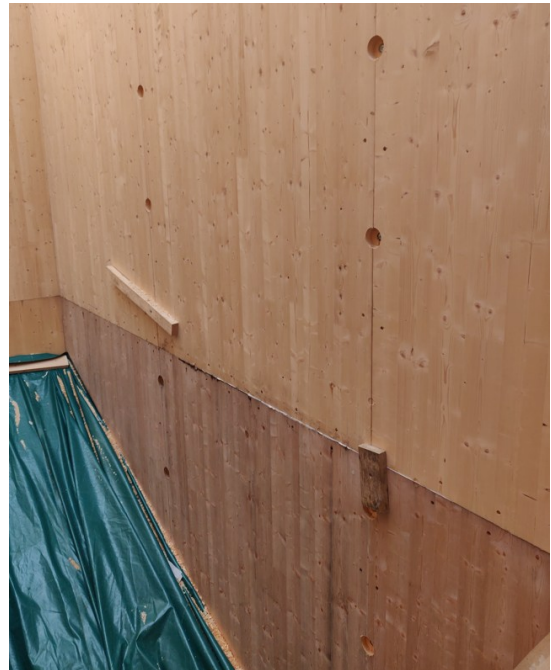
Figuur 146 - Zeilengebruik in trappenhuizen. Hierdoor wordt neerslag afgeleid tot diep in de constructie, waarna een goede drainage nodig is. Tegelijkertijd ziet men ook het kleurverschil bij de panelen ten gevolge van bevochtiging en UV-straling en zijn de ldefix-verbindingen zichtbaar.
