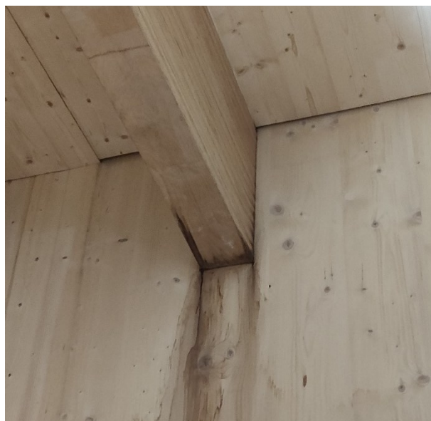
Figuur 142 - Verkleuring nabij een aansluiting van een glulambalk met een tussenvloer als gevolg van vochtintrasie. Mechanische droging was vereist om de hoge vochtgehaltes (max. 44%) te doen dalen.
