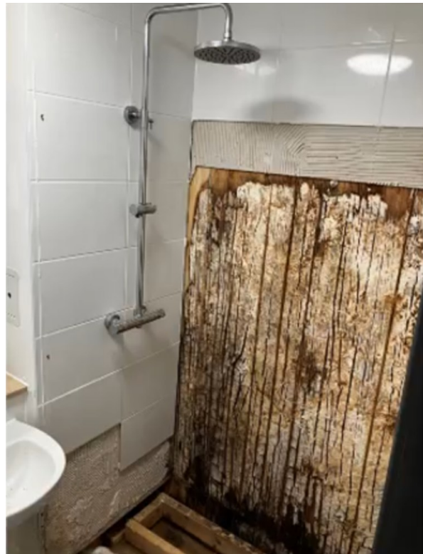
Figuur 43 - Vergevoerde schade in een vochtige ruimte. Hier was de tegelafwerking simpel verlijmd op de panelen, waartoe afstromend water van de douche - overigens in een warme ruimte - kon opstapelen (Clifford 2025).
