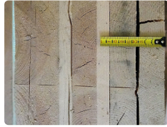
Delaminatie door overmatig drogen - © K. Kalbe
