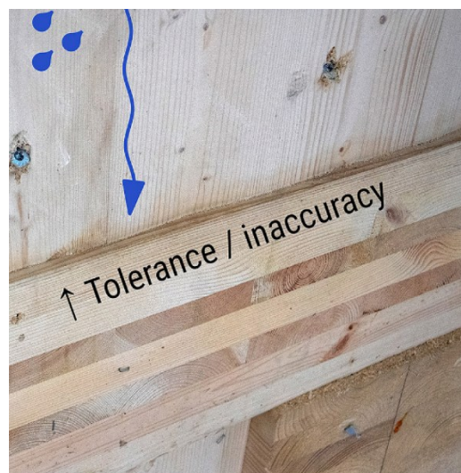
Figuur 91 - Pooling ter hoogte van de bouwnaad door uitvoeringsimperfecties (Kalbe et al., 2022a).
