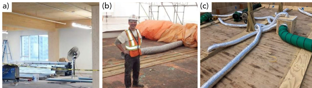
Figuur 126 - Mechansiche luchtstroming om bovenliggend vloerpaneel te drogen (a). Gerichte mechanische droging via zeilen (b). Gerichte mechanische droging aan stootbordverbindingen en dakranden via tijdelijke omkastingen (c). (Clifford, 2025c; Gagnon & Karacabeyli, 2019; Finch, 2024).
