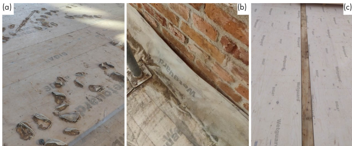
Figuur 139 - Werfbeschadiging van het beschermingsmembraan (a). Gebrekkige verbinding van datzelfde membraan met een bestaande metselwerkwand (b). Onbeschermde stootbordverbinding (c)
