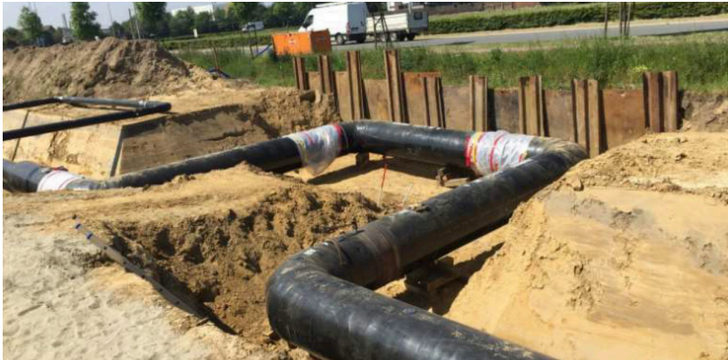
Figuur 32 Ondergrondse stoomleiding in de haven – Oostrozebeke (Provincie Oost-Vlaanderen & ABDE Solutions, 2023).
