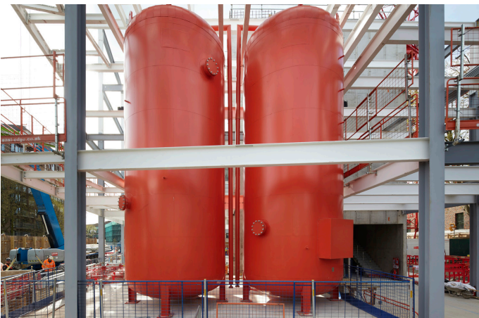
Figuur 23 Energieopslagsysteem, Rode watertank dat zich over twee verdiepingen uitstrekt (Morris+Company, 2018).
