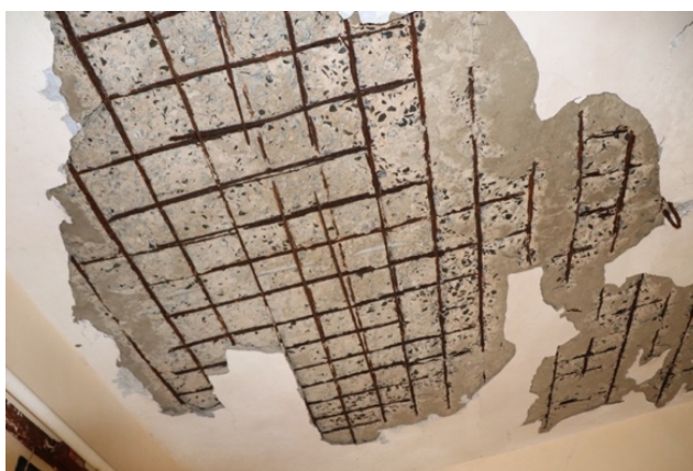
Figuur 110: Betonschade door wapeningscorrosie carbonatie-gerelateerd. Overgenomen van What is concrete spalling , door Armorsil, 2023.
