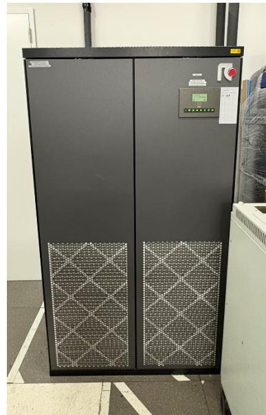
Figuur 16: Klimaatkast energielokaal
