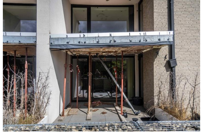
Figure 16: Decay damage in Belgium ( https://www.nieuwsblad.be/regio/limburg/sint-truiden/zien-eigenaars-ooit-iets-van-hun-centen-terug-proces-rond-rotte-appartementen-van-start/87714404.html )
