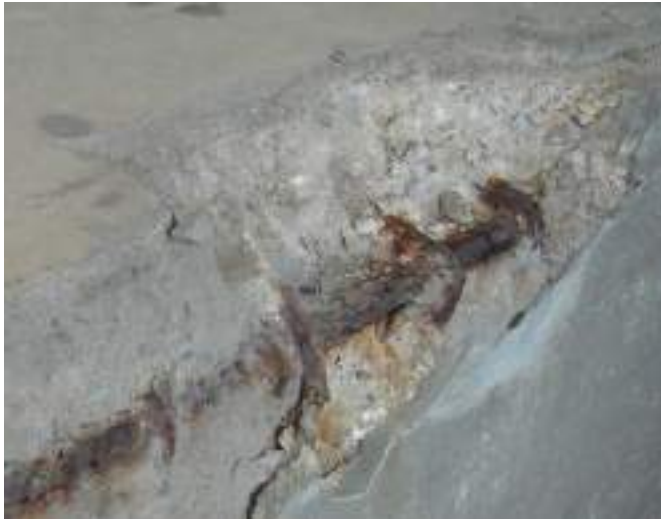
Afb. 3 Carbonatatie veroorzaakt corrosie bij wapening (Wikipedia)
