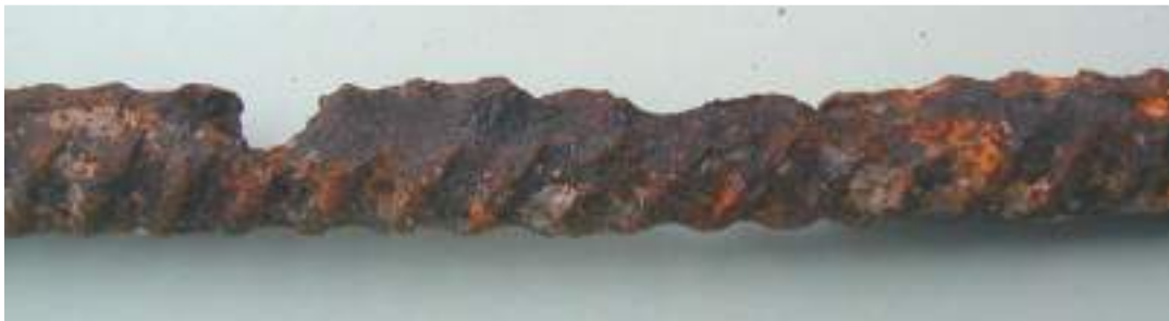
Afb. 8 Putcorrosie door chloriden (Buildwise – voormalig WTCB)
