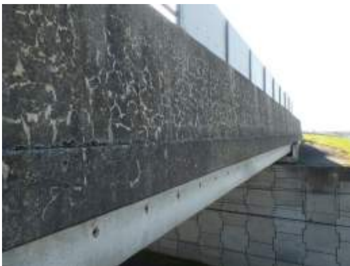
Afb. 31 Voorbeeld scheurvorming door ASR (FEBE)
