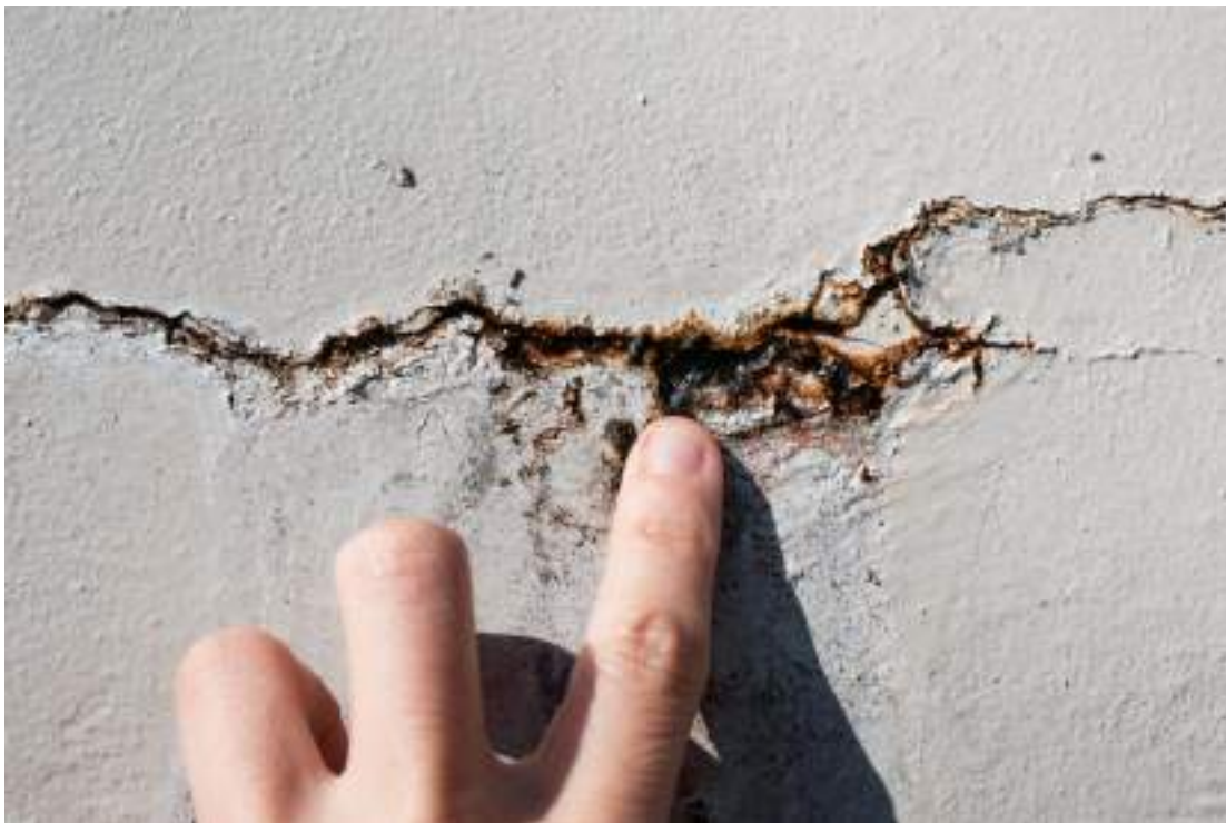
Afb. 2 Scheurvorming en roestvlekken (Adobe Stock)
