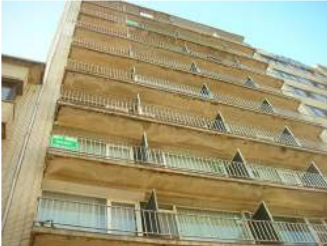
Afb. 34 Wapening in balken zichtbaar langs onder (Joost Beke)
