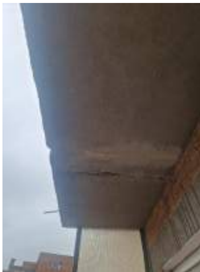
Afb. 27 Afbrokkeling (eigen foto)
