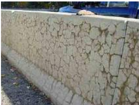
Afb. 10 Scheurvorming door ASR ( Wikipedia)
