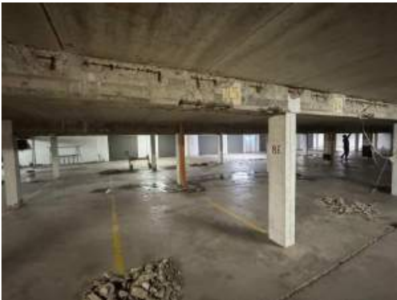
Afb. 41 Betonrotverschijnsel in ondergrondse parkeergarage (Bozica)
