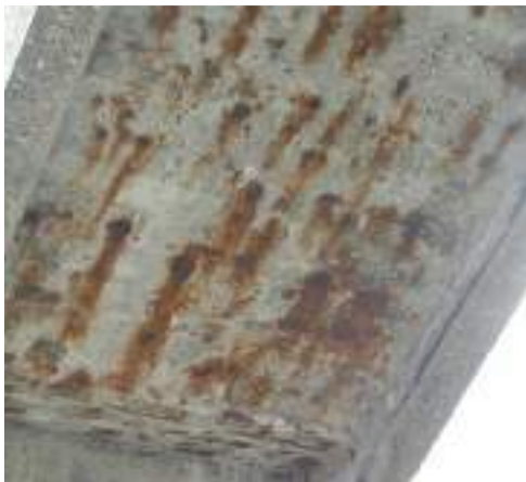
Afb. 13 Roestplekken onderaan een trap (Buildwise – voormalig WTCB)
