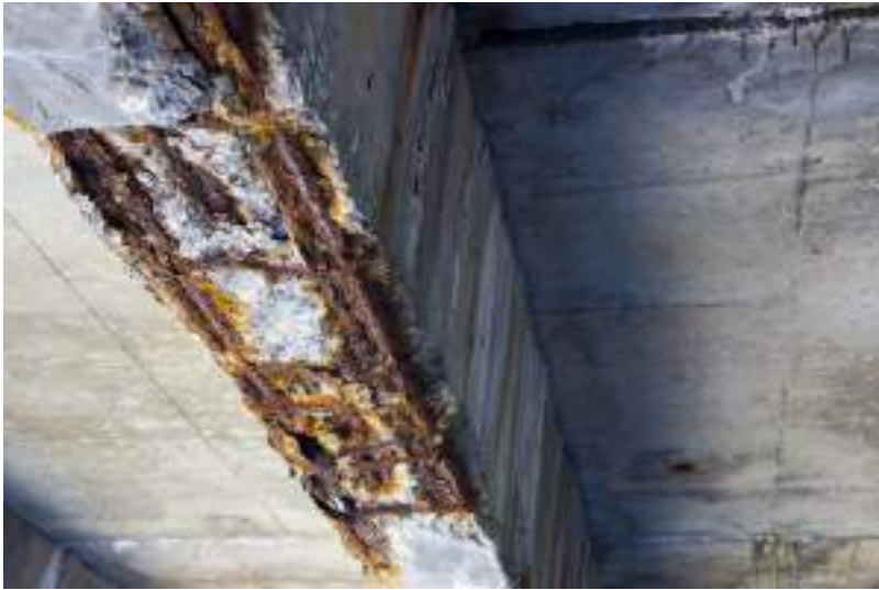
Afb. 40 Corrosie van wapening in prefab betonbalk (UGent)
