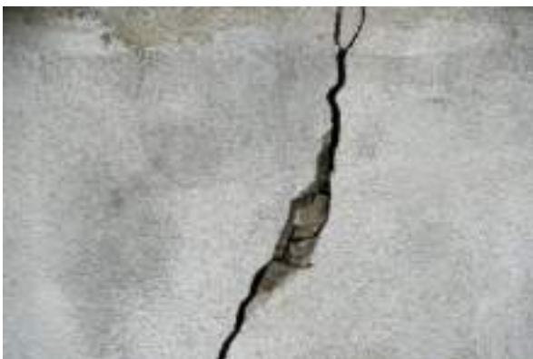
Afb. 9 Voorbeeld van scheurvorming (A-quin)
