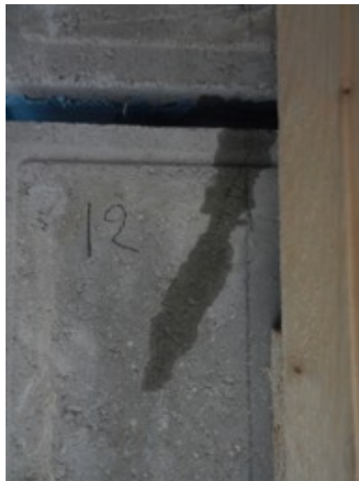
Figuur 3.5 Waterlek ter plaatse van barst in betontegel
