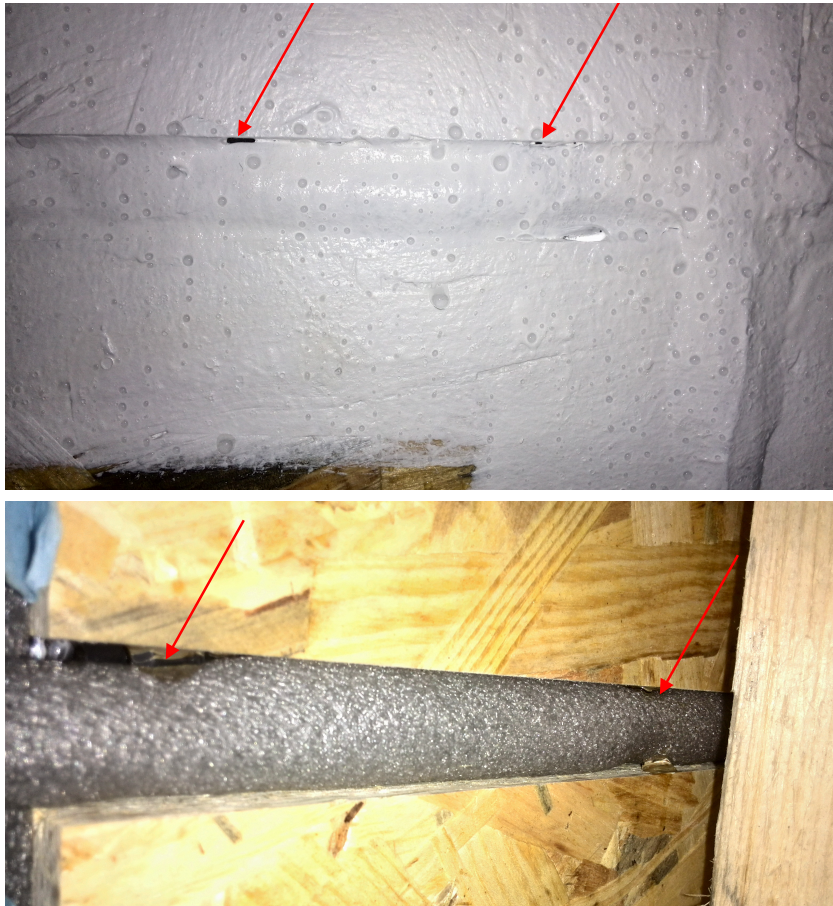
Figuur 3.4 Waterlekkage ter hoogte van opening coating
