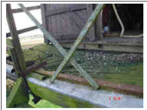
Figuur 113: Balkon in slechte staat
