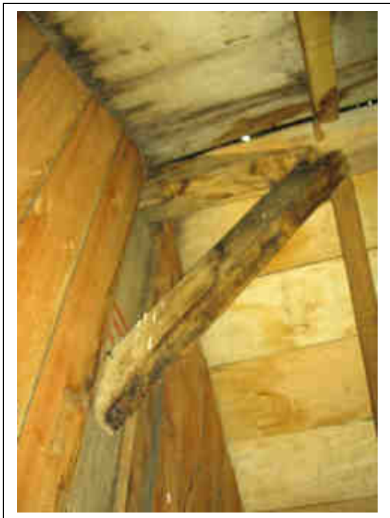
Figuur 80: Dak – schaliënberd met gaten
