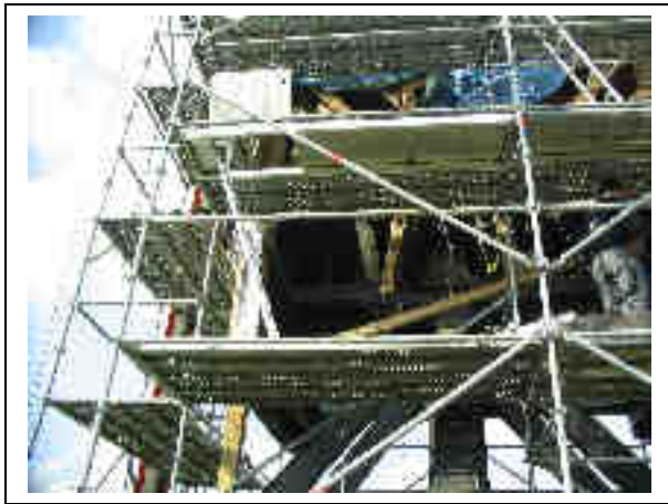
Figuur 128: Rondom de molen werd een stelling geplaatst voor de lichting. In het midden van de foto kan u de spoorstijl zien hangen. Hier ziet u goed dat zij schuin loopt
