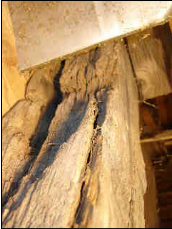
Figuur 83: Aangetaste steenbeddebalk van de steenzolder
