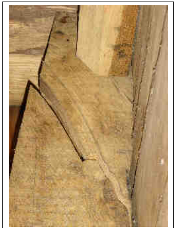
Figuur 78: Barst in de spoorstijl aan het steenrecht
