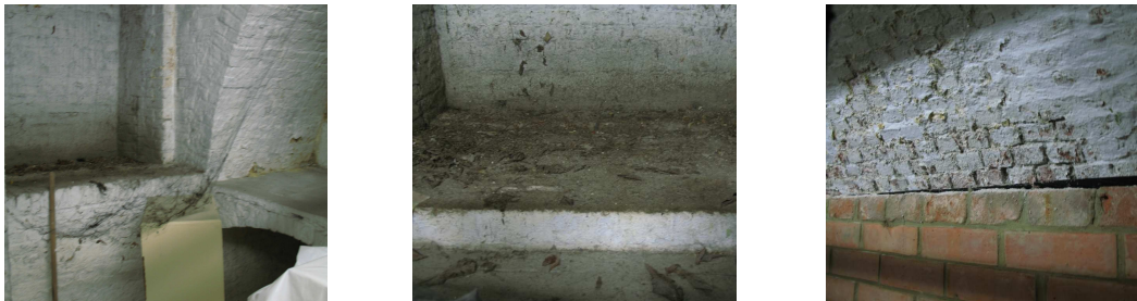
Afb. 25 Grote hoeveelheden vuil en zoutafzettingen op de muren
