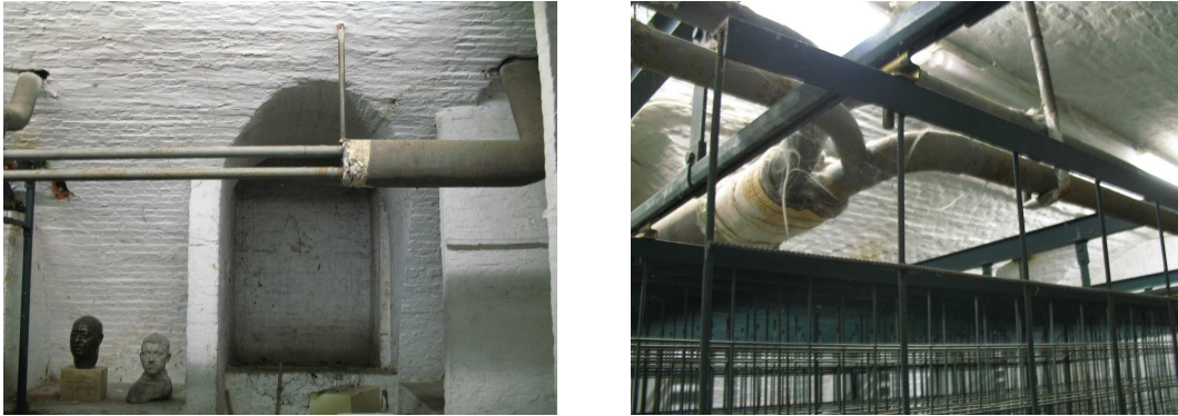
Afb. 24 Details van onafgeschermd leidingen
