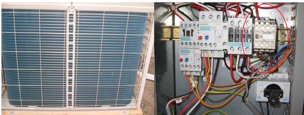
Figuur 3.55: Coil van Daikin toestel en plaatsing nieuwe contactor
