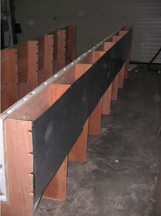
Figuur 3.61: Installatie verwarming in achterkant bankenstelsel
