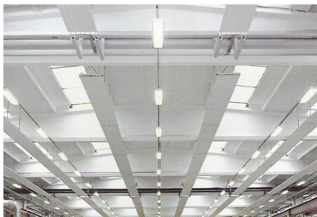
Figuur 74 : stralingspanelen aan het plafond_Sabiana
