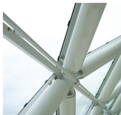
Figuur 69 : sprinklers aan de constructie bevestigd_Hessing Cockpit_W.Sorgeloos
