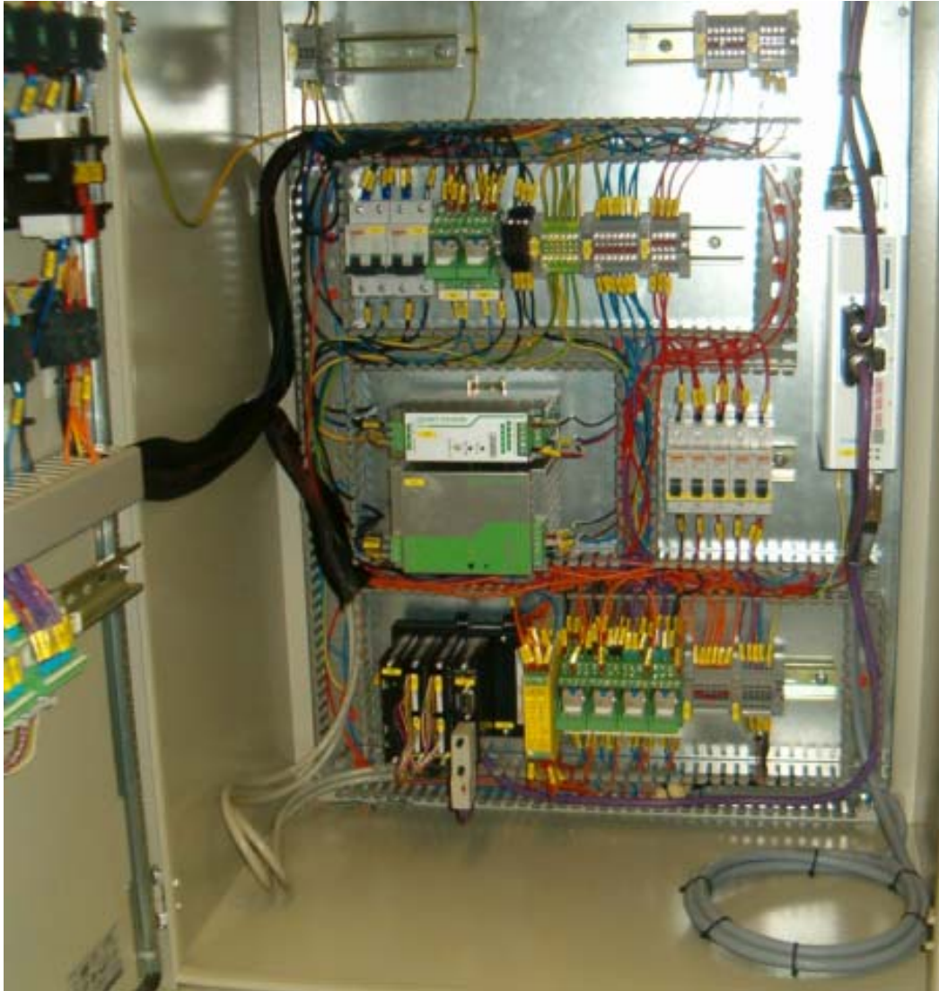
Figuur 6.17: Montageplaat met gemonteerde draden
