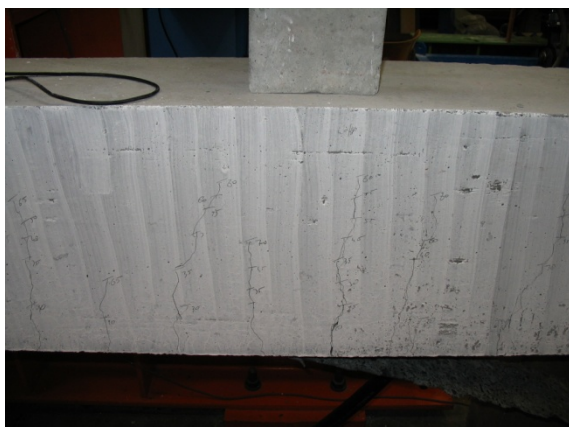
Figuur 214: Scheurvorming linkerkant balk BL2.2
