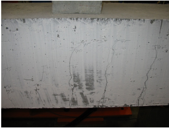
Figuur 127: Scheurvorming linkerkant balk BLA2.4
