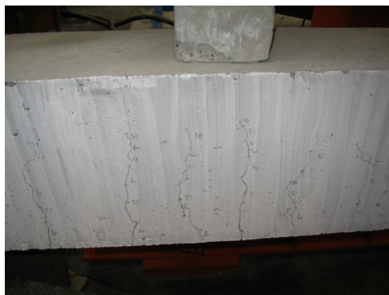
Figuur 215: Scheurvorming rechterkant balk BL2.2
