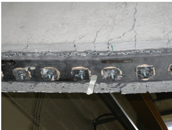
Figuur 208: Onthechting door scheuroverbrugging
