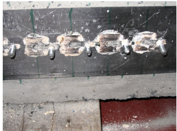
Figuur 200: Inscheuringen in de koolstofvezelwapening
