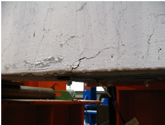
Figuur 110: Aanzet tot concrete rip-off scheur
