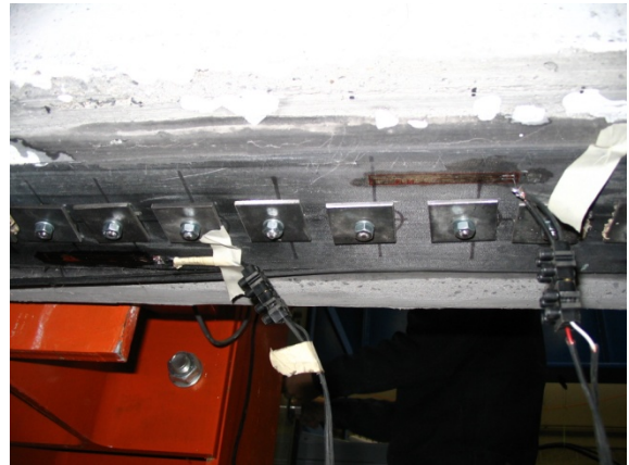
Figuur 147: Inscheuringen in de koolstofvezelwapening
