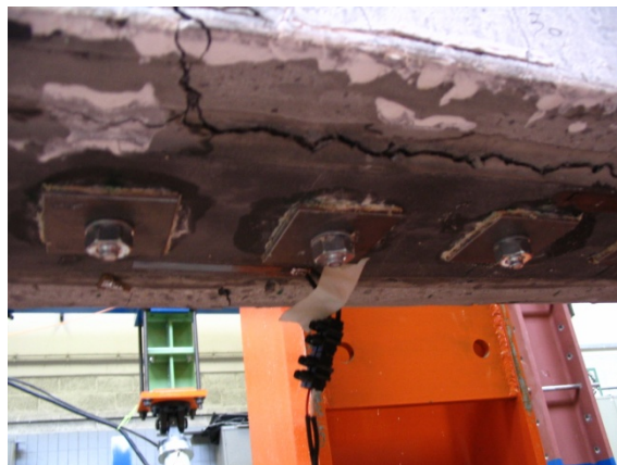
Figuur 121: Onthechting door scheuroverbrugging [2]
