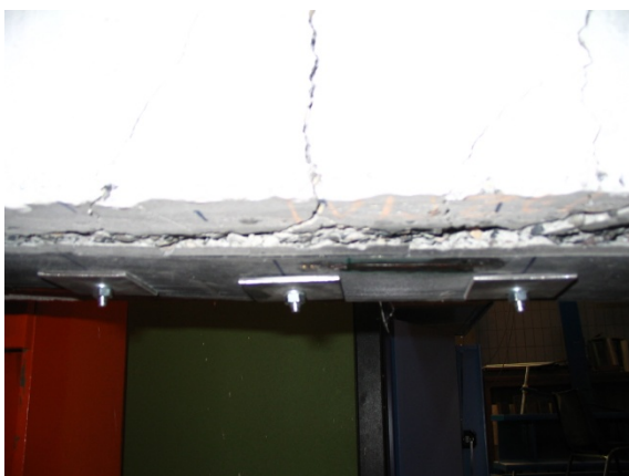
Figuur 52: Linkerankers gedeeltelijk uit het beton getrokken
