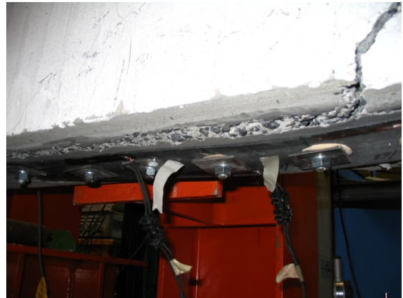
Figuur 157: Ankers na de herbelasting
