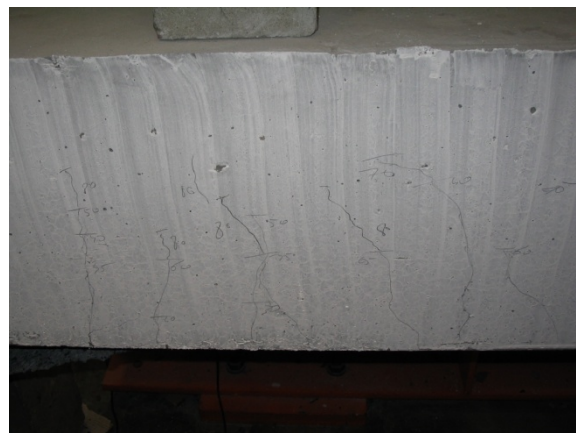
Figuur 95: Scheurvorming rechterkant balk BL2.1
