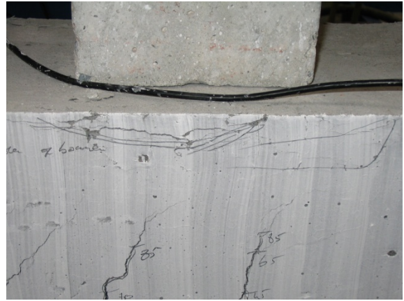
Figuur 180: Verbrijzeling van het beton in de drukzone
