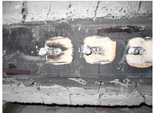
Figuur 182: Inscheuringen na de herbelasting
