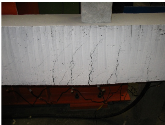
Figuur 135: Scheurvorming linkerkant balk BLA2.5
