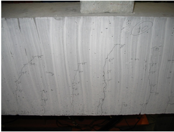
Figuur 144: Scheurvorming linkerkant balk BLA2.6
