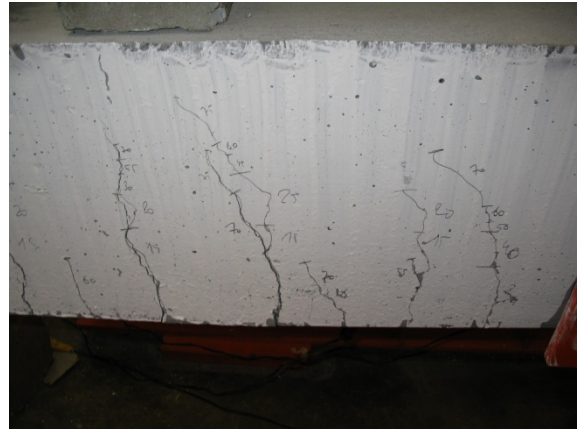
Figuur 128: Scheurvorming linkerkant balk BLA2.4
