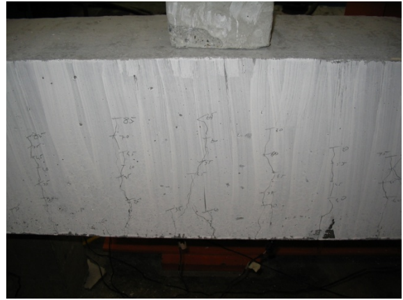
Figuur 145: Scheurvorming rechterkant balk BLA2.6
