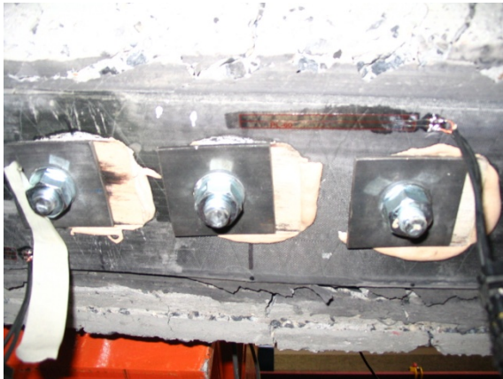
Figuur 181: Inscheuringen in de koolstofvezelwapening
