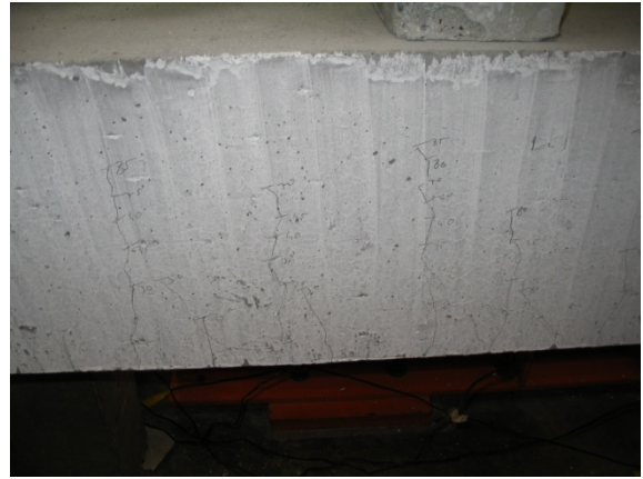
Figuur 155: Scheurvorming rechterkant balk BLA2.7
