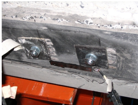
Figuur 174: Inscheuringen in de koolstofvezelwapening
