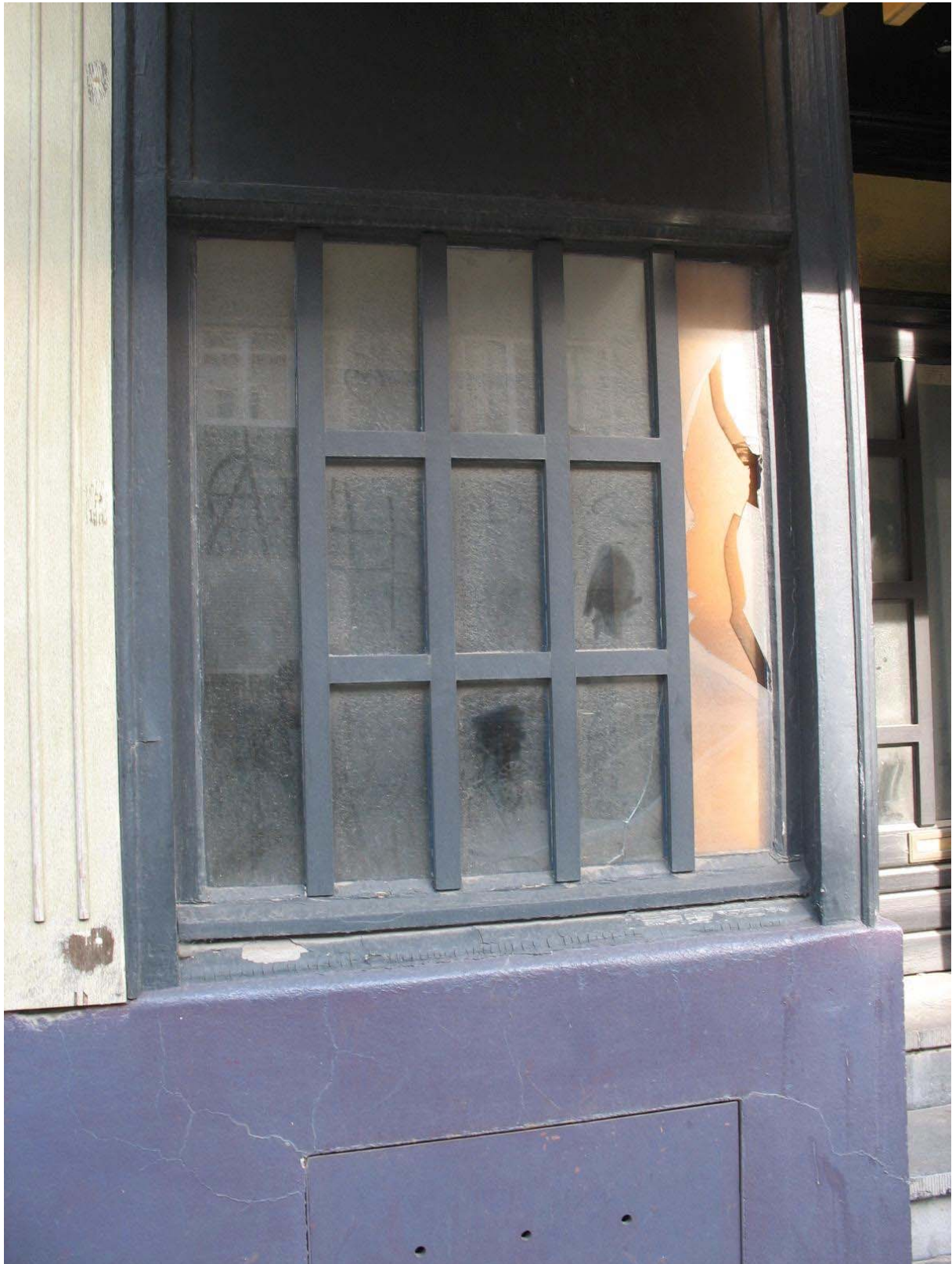
Foto 8: Nog een voorbeeld van een leegstaand gebouw in deze buurt, met ook de typische “Broken Window” en veel stof...
