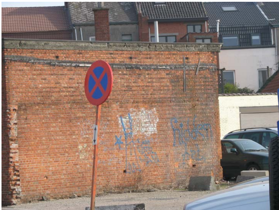
Foto 2: Een duidelijk onverzorgde gevel van een leegstaand huis...
