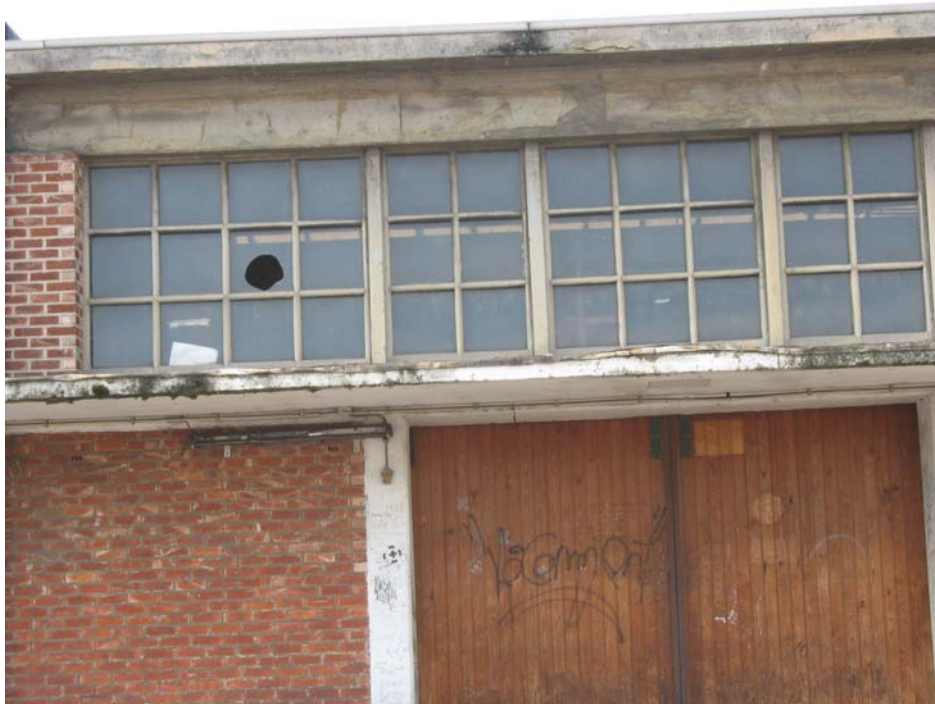
Foto 1: Een typisch leegstaand gebouw naast het station met de typische “Broken Window”, graffiti en onverzorgd uitzicht
