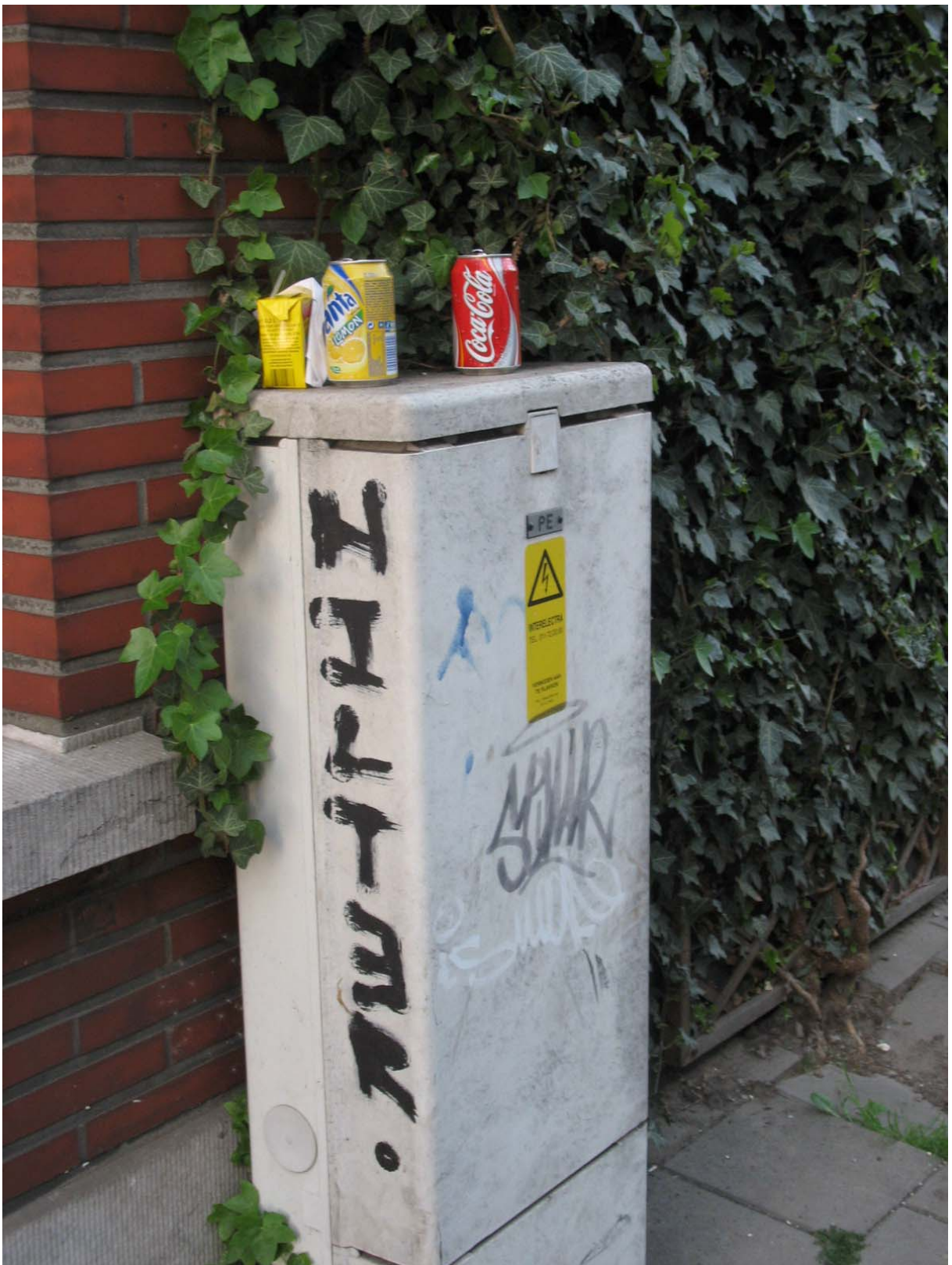
Foto 17: Een vervuilde electriciteitskabine...
