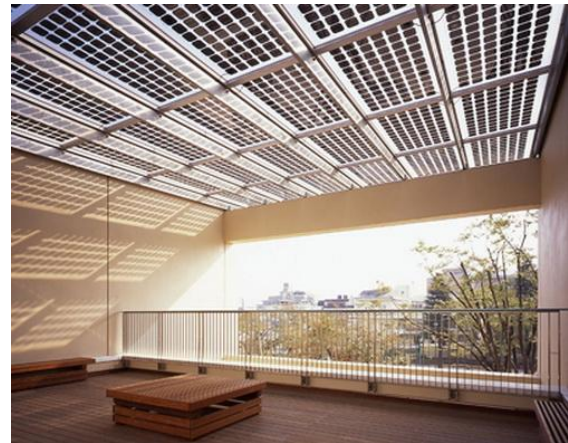
Figuur 1.22: Transparante modules in een dak
