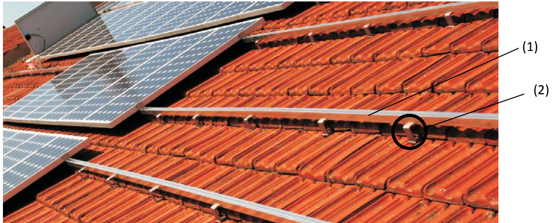
Figuur 1.17: Bevestiging van zonnepanelen op hellende daken
