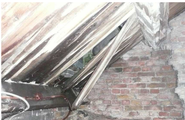
Figuur 2.5 Verrotting en inzakking van het dak door insijpelend regenwater
