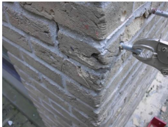
Figuur 112: Metselwerk randbreuk
