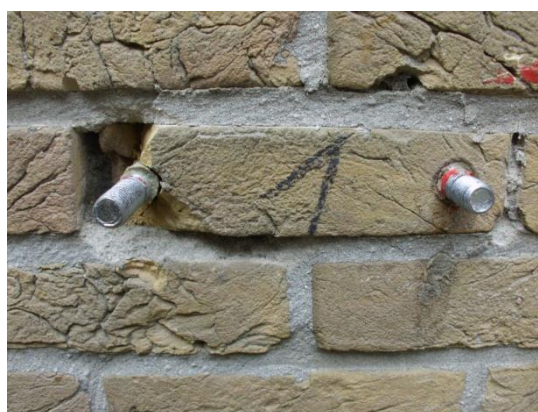
Figuur 110: Metselwerk achteruitbreken
