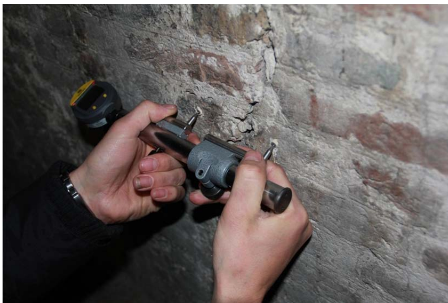
Figuur 60: opmeten scheur met behulp van de Huggenberger
