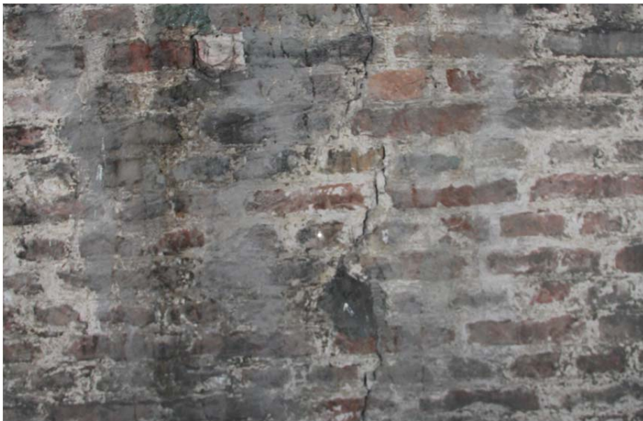
Figuur 57: middelste scheur zolderverdieping
