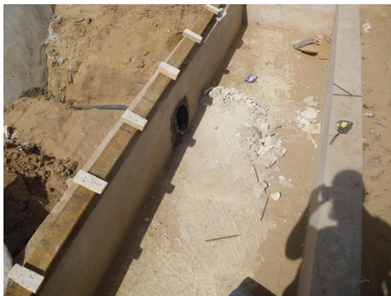
Figuur 33: PVC uitlaatbuis en digestaatopslag
