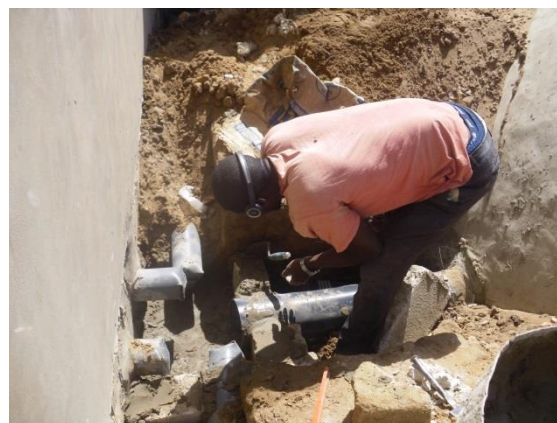
Figuur 18: Verbinding toiletten met biogasinstallatie
