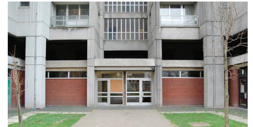
afbeelding 57 - Zicht op de originele inkom, met op de eerste verdieping de oorspronkelijke terrassen.
