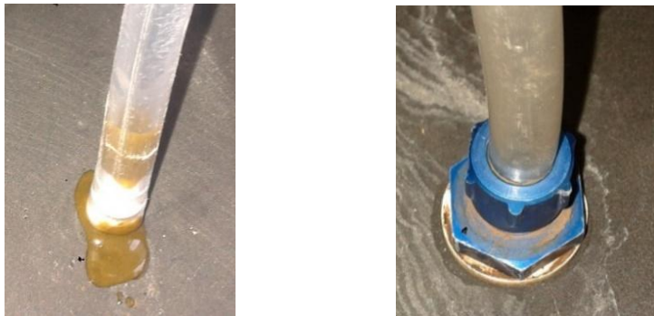
Figuur 18: Oude (links) en nieuwe (rechts) gasconnectie
