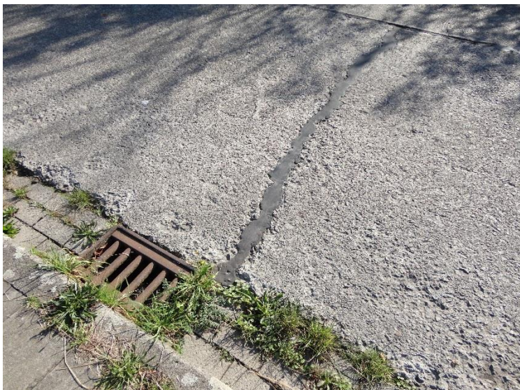
Figuur 2-15 : Schade ontstaan door waterslikker (Locatie: Bloemlandstraat Denderleeuw)
