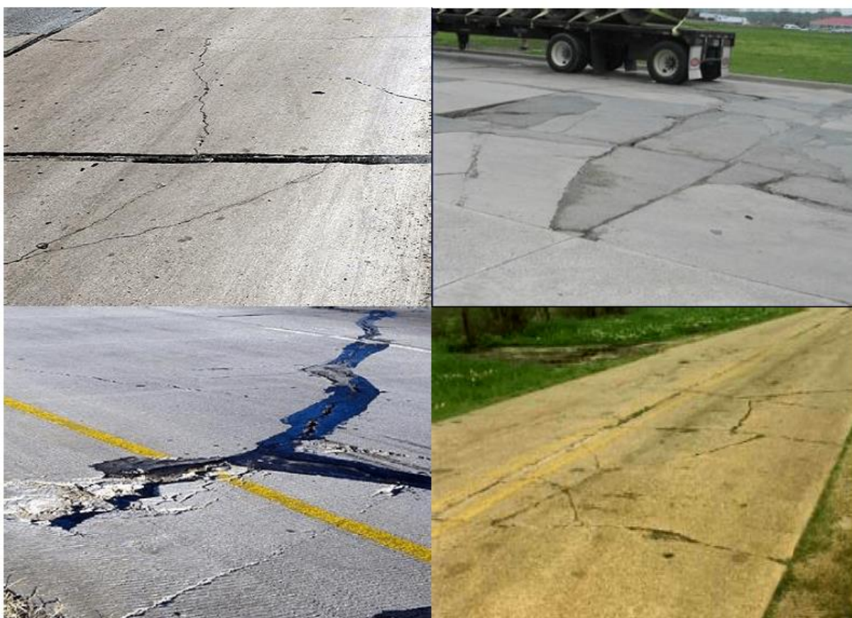
Figuur 2-14 : Gebroken platen
