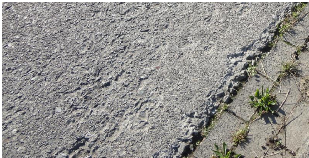
Figuur 2-6: Afschilfering van betonoppervlak (Locatie: Bloemlandstraat Denderleeuw)
