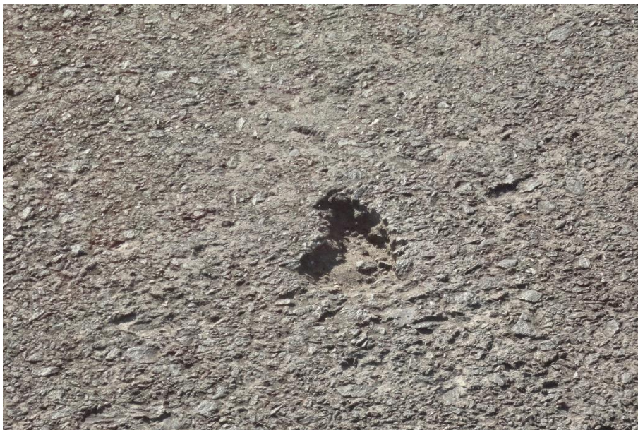
Figuur 2-7: Gat ontstaan in betonoppervlak (Locatie: Bloemlandstraat Denderleeuw)
