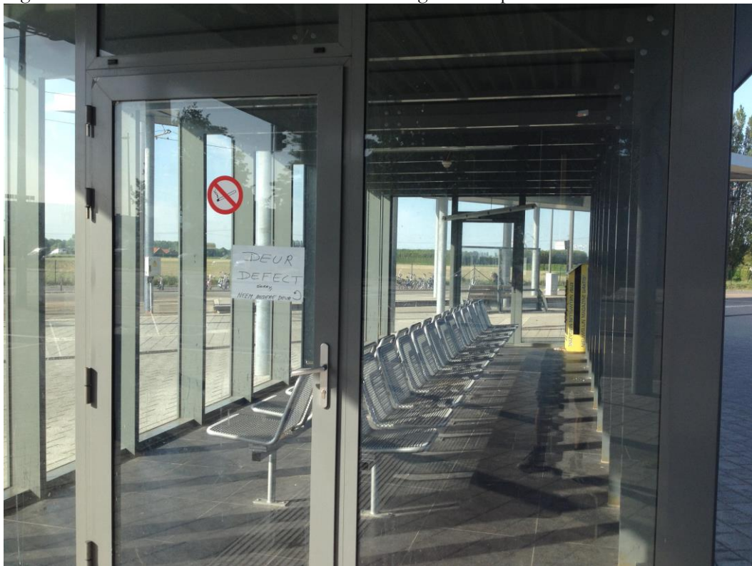
Fig. 5.73.: Wachtruimte met defecte deur en loshangende lamp
