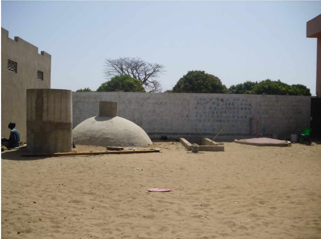
Figuur 4: Overzicht biogasinstallatie
